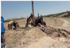
حفر و تجهیز چاه روستای چوانباغ و جیران سفلی اعتبار: ۴۵ میلیارد ریال
